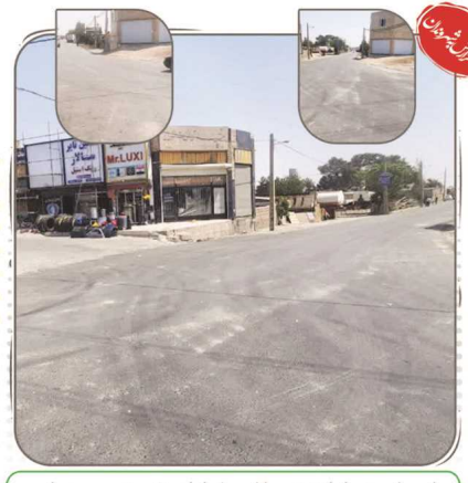
اجرای عملیات عمرانی خیابان شهید محمدیان پروژه روکش مکانیزه آسفالت به مساحت ۲۰۰۰ مترمربع
